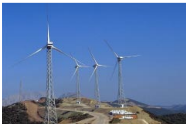
Ferme éolienne de Tétouan à Koudia Al Baïda (Maroc) Éoliennes sur le site d'implantation de la compagnie éolienne du Détroit La médiathèque EDF/Daniel Riffet
