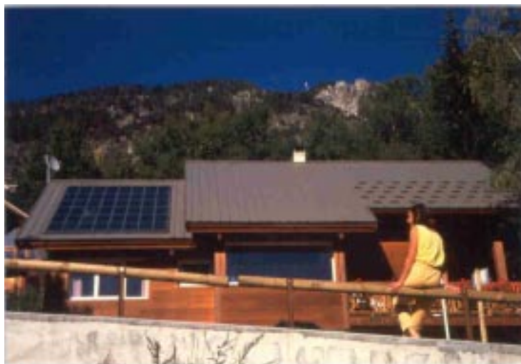
Capteur thermique d'un plancher solaire direct à Briançon photo : Ademe/R. Bourguet
