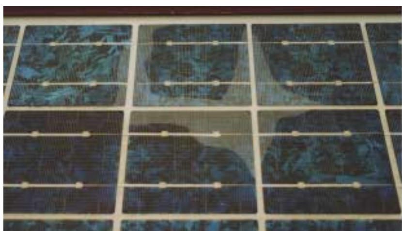
Installation 1994 : Délaminage conséquent formant grossièrement un U (longueur développée de 30cm environ)
