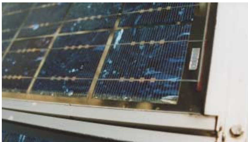
Installation 1987 : Corrosion sur plusieurs centimètres des connexions principales et opacification visible continue de 2cm en rive basse
