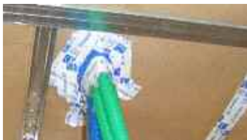
Le passage des gaines est défectueux : de l'air va s'infiltrer entre les gaines.
