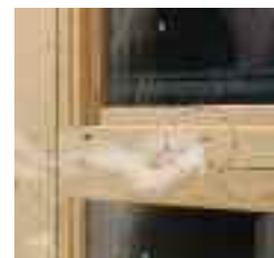
Défaut d'étanchéité de la fenêtre au niveau des orifices de drainage détecté par la poire à fumée
