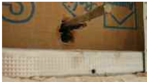
Traversée de la tige métallique pour volets roulants. Défaut repéré après le test d'étanchéité final.
