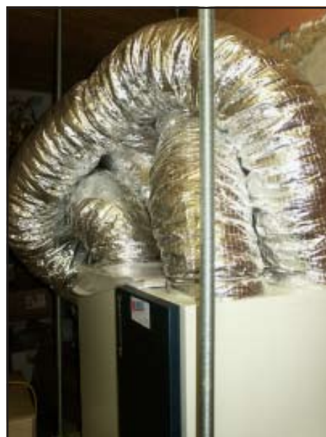
Ventilation et échangeur de chaleur
