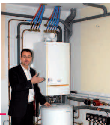
Chaudière-gaz De Dietrich avec départ vers le plancher chauffant et les radiateurs.
