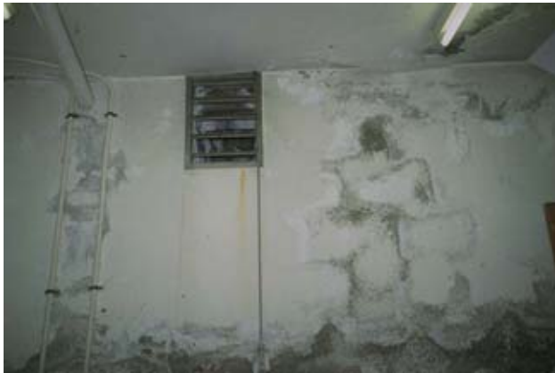
Figure 3.1 : Taches de moisissures (EPQR Rénovation).
