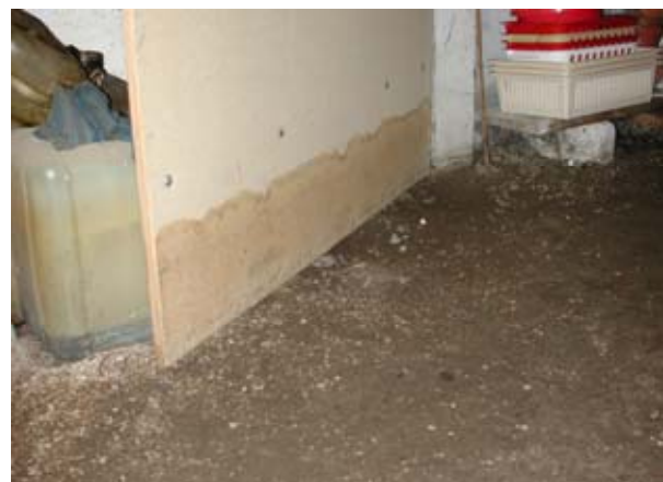
Figure 3.4 : Remontée d'humidité (EPQR Rénovation).
