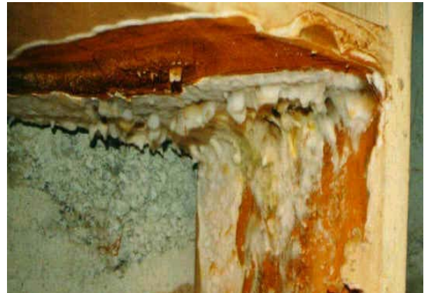
Figure 3.2 : Mérule (F. Baer, Holzschutz)
