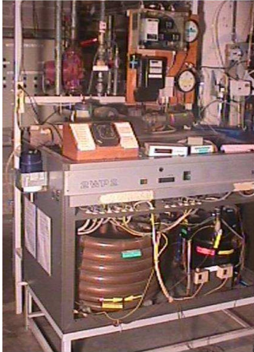
Figure 4: Vue d'ensemble de la PAC Siemens.
