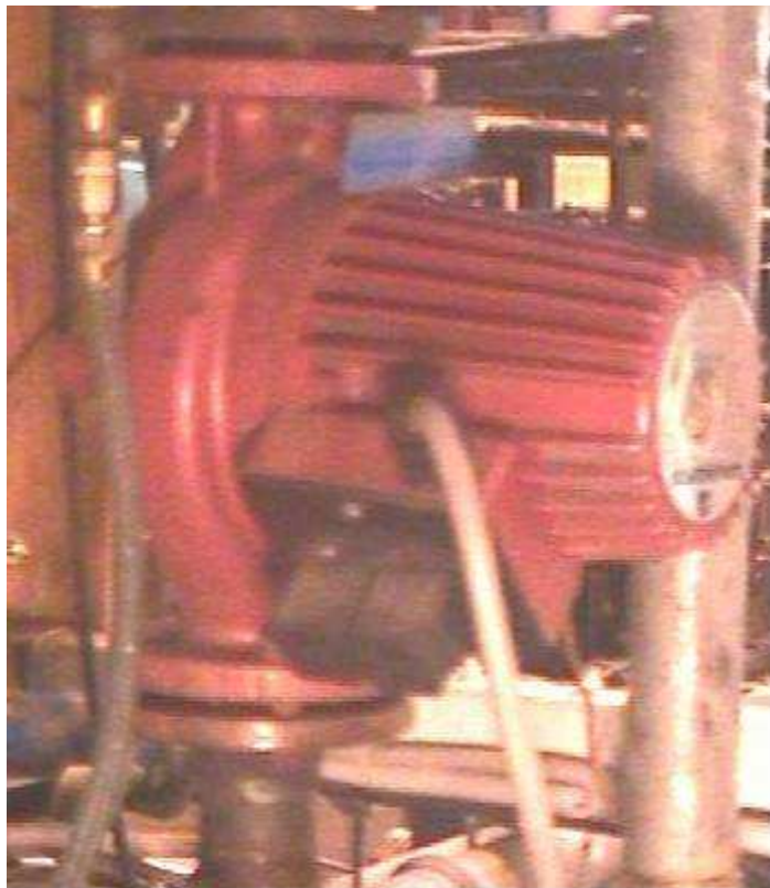
Figure 13: Vue du circulateur d'évaporateur (puissance consommée : 150 W)
