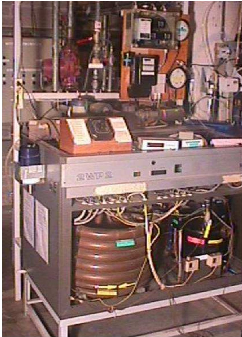
Figure 4: Vue d'ensemble de la PAC Siemens.
