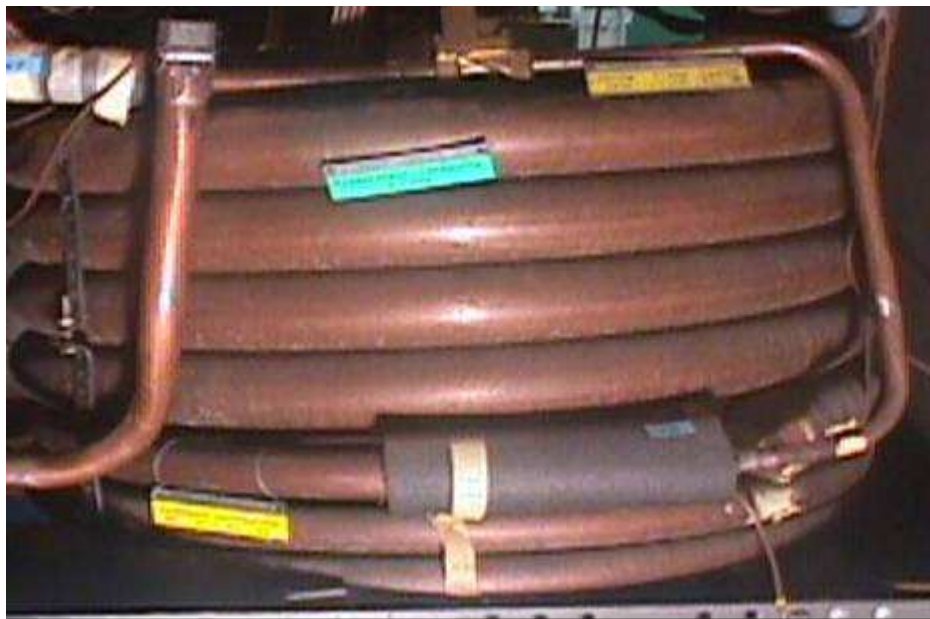
Figure 10: Vue arrière de l'évaporateur plus échangeur de la PAC.
